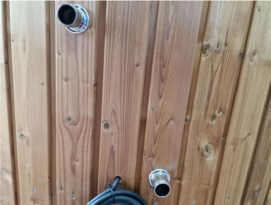
Abbildung 27: Darstellung des 230 V-Schuko-Steckers des Hot Tubs (rechts daneben: Vorbereitung für die Sandfilteranlage (Wasser-Rücklauf zur Sandfilteranlage)) aus rostfreien V4A-Anschlüssen
